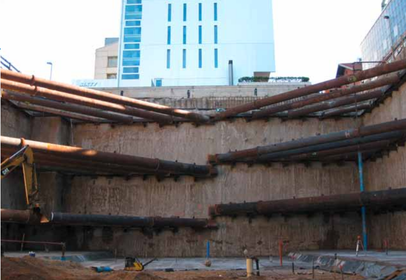
Komplettleistung Baugrube für ein Bürogebäude im Düsseldorfer Medienhafen; Gewerke: Schlitzwände, Bohrpfahlwand, rückbaubare Anker, Aussteifung und Erdarbeiten.
