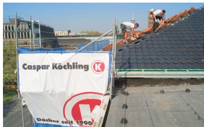
Dachdeckerarbeiten mit eigenem Fachpersonal gehören heute noch zum Kerngeschäft bei Caspar Köchling.
