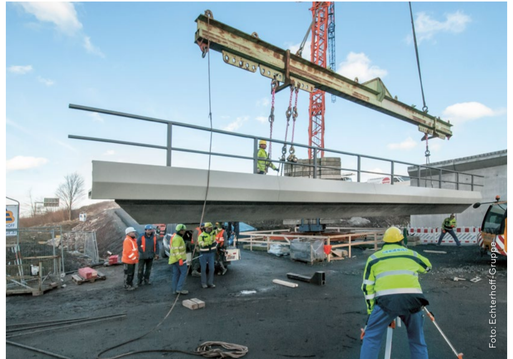
Das Brückengeländer kann bei der Hybridkappe bereits vor dem Einbau der Stahlkonstruktion montiert werden. (Anm. der Redaktion: Das Foto entstand vor Einführung der Corona-Schutzverordnung.)
