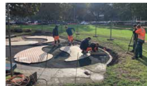
Auszubildende aus dem ABZ Kerpen und dem Grünflächenamt bei den Arbeiten am Brunnen.
