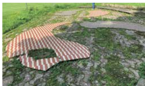
Bis zu seiner Sanierung fristete der aus den 1950er Jahren stammende Toto-Brunnen ein trauriges Dasein.
