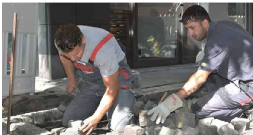
Werbung für den Bauberuf: Straßenbauer-Azubis aus dem ABZ Oberhausen beheben Pflasterschäden in der Mühlengasse der Düsseldorfer Altstadt.
