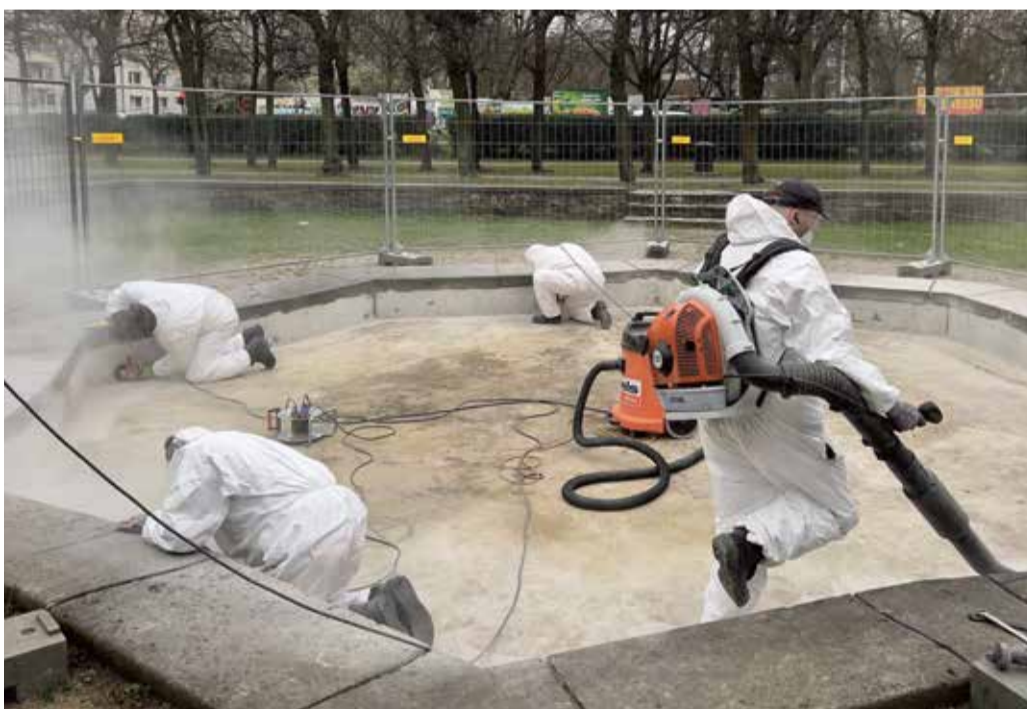
// Die Azubis der Unternehmen Strabag, Köhler Sonderbau, Elfein Isolierbau und Asphalt Kleemann gehen motiviert ans Werk.
