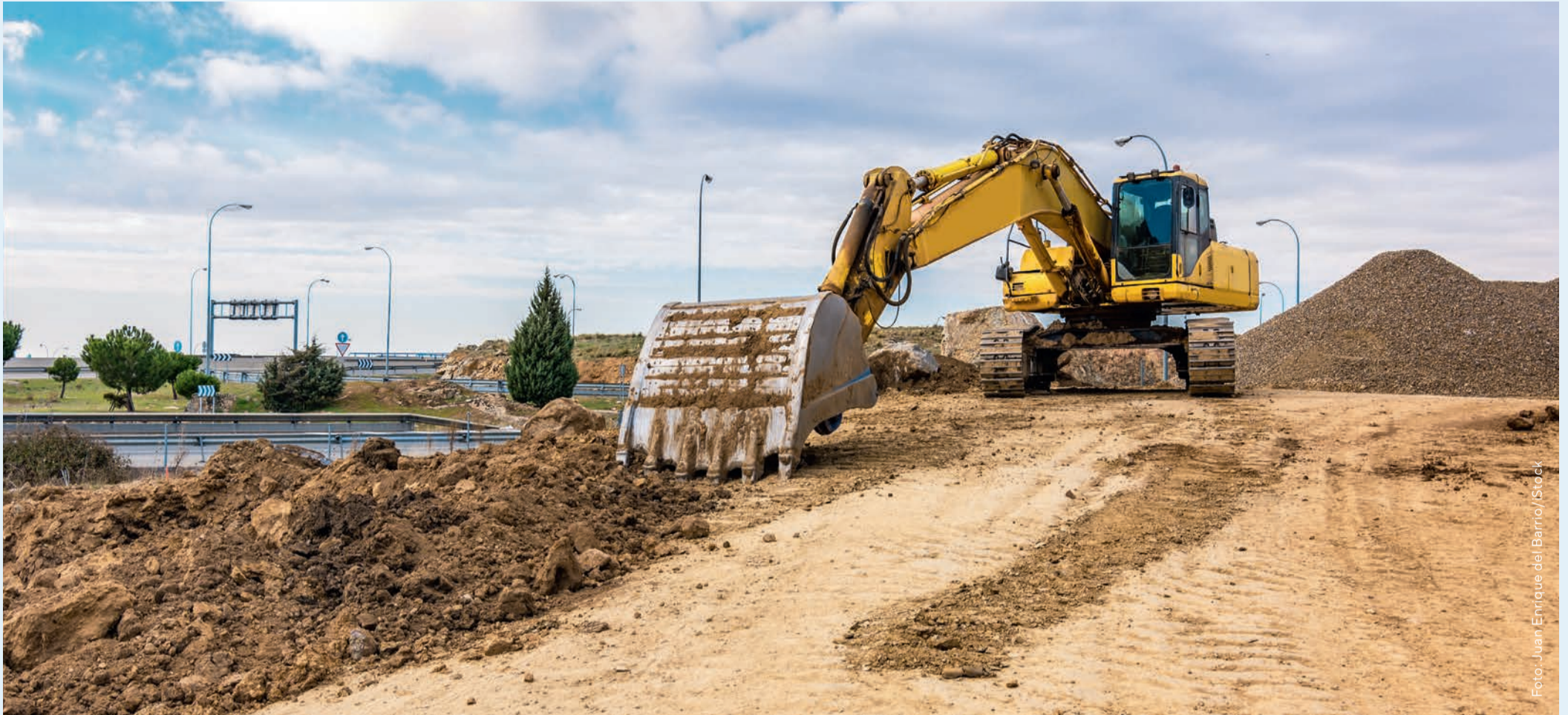
Um Schäden zu vermeiden, ist die Einholung von Leitungsauskünften vor Beginn von Tiefbaumaßnahmen unerlässlich.
